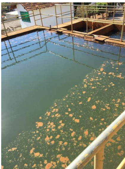
Fotografia 8 - Reservatório de decantação
