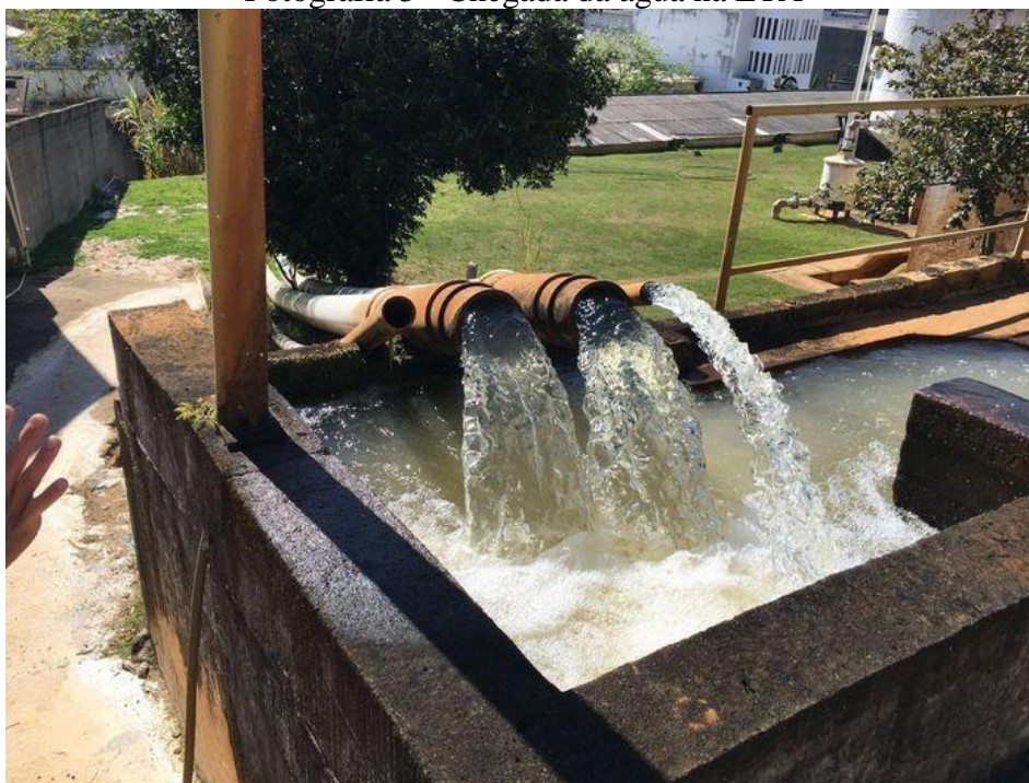
Fotografia 3 - Chegada da água na ETA
