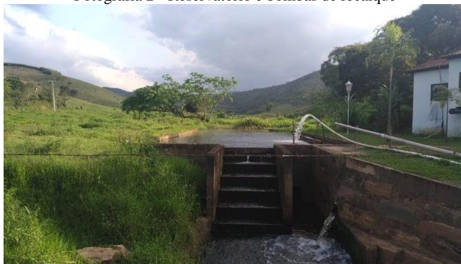
Fotografia 2 - Reservatório e bombas de recalque
