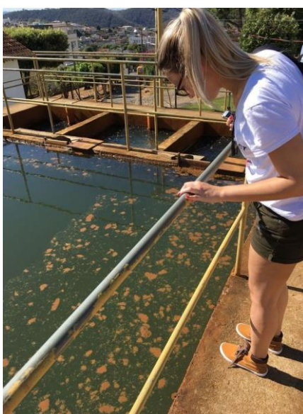
Fotografia 7 - Reservatório de decantação
