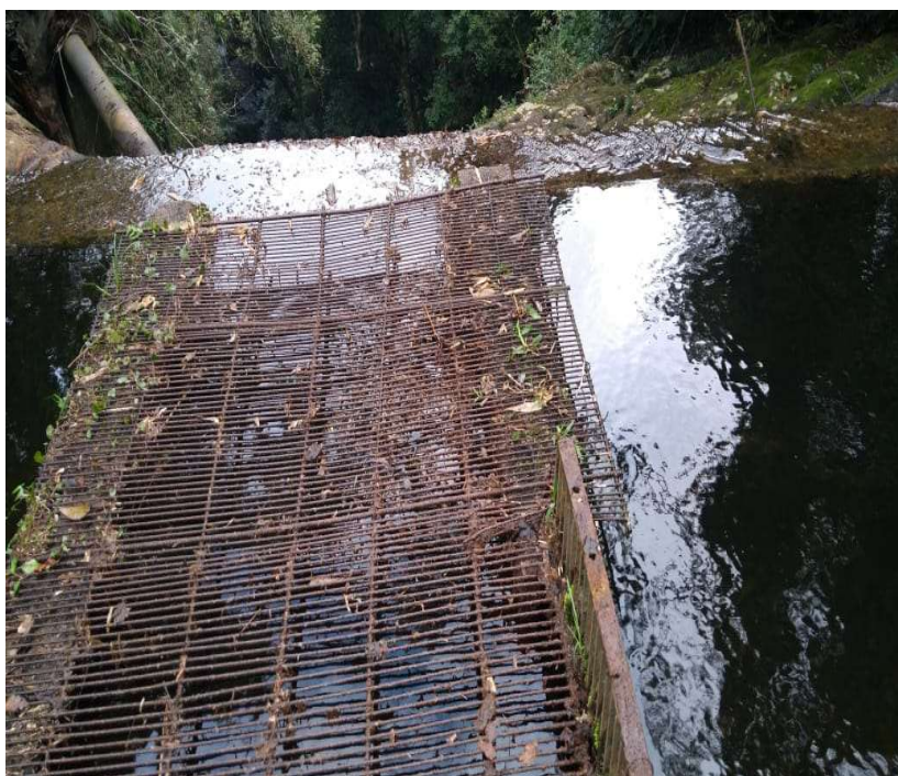
Figura 6- Barragem no Rio Vermelho
