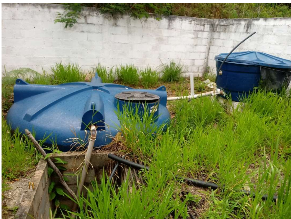
Figura 7- Cisterna (local de armazenamento da água não tratada) situada no bairro Cidade Alta localizado no município de Santa Maria Madalena - RJ
